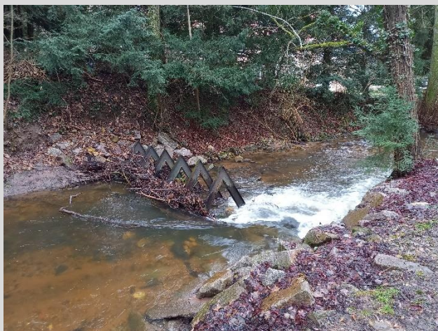
Dégagement d'un piège à embâcle lors des tournées de surveillance après les crues (ouvrage à Obernai)
