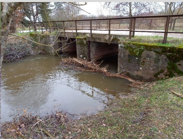
Embâcle formé au niveau d'un pont à pilier sur l'Andlau à Zellwiller
